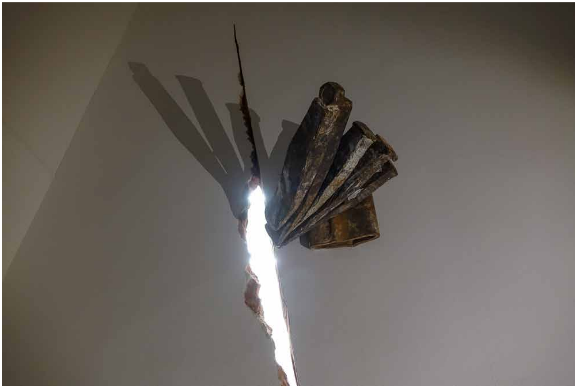
Fessura e Compressione , muro e ferro di cava, 2016 (Foto Nereo Rapetti)
